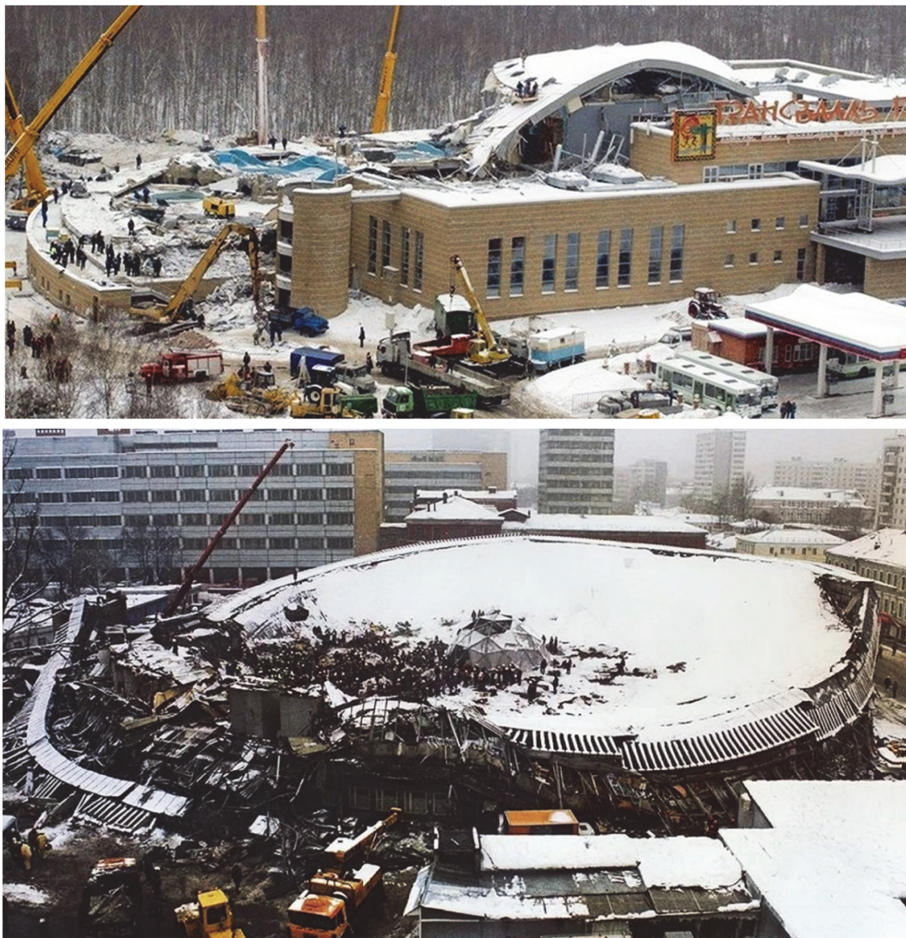
Рис. 1. Обрушение пространственной конструкции покрытия здания Трансвааль-парка, Москва ( сверху ) и здания Басманного рынка, Москва ( снизу ) Figure 1. The collapse of the elite structure of the covering of the Transvaal Park building, Moscow ( above ) and the building of the Basmannyi market, Moscow ( below )
