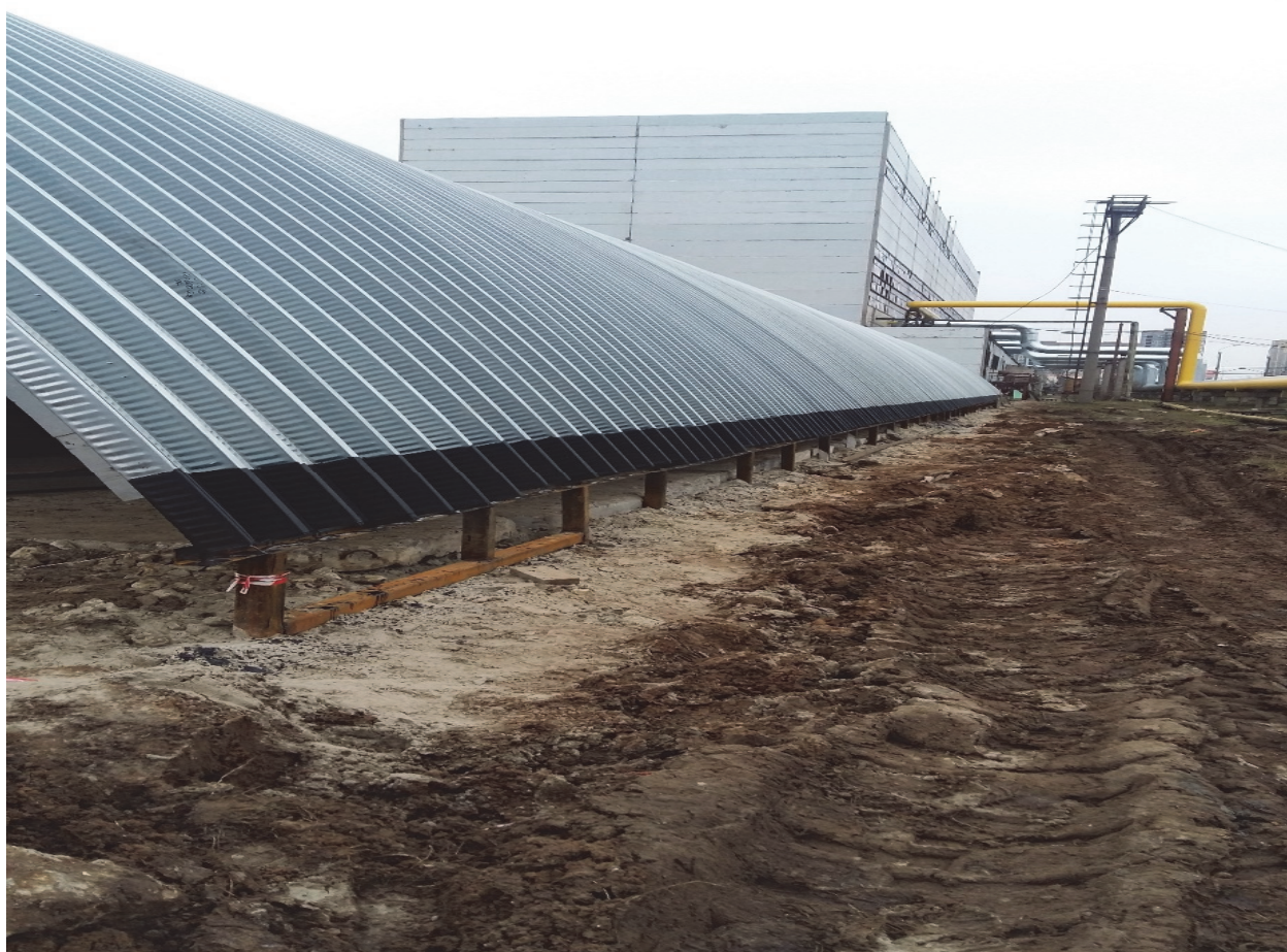
Рис. 5. Анкерные стойки сечением из квадратной трубы 80 \times 80 \times 5 мм с шагом 1,9 м (фото Д.М. Хусаинова) Figure 5. Anchoring pillar with a section of a square pipe 80 \times 80 \times 5 mm with a step of 1.9 m (photo by D.M. Khusainov)
