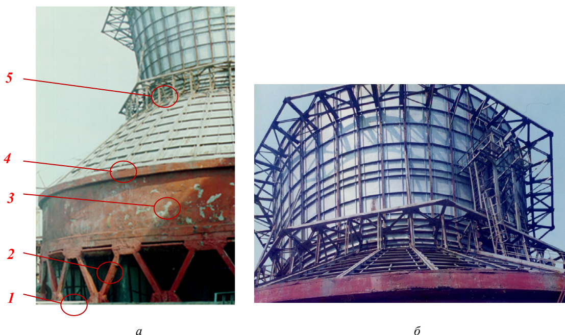
Рис. 1. Крупногабаритная градирня: а — общий вид; б — металлическая часть И с т о ч н и к: выполнено Н.М. Якуповым.
