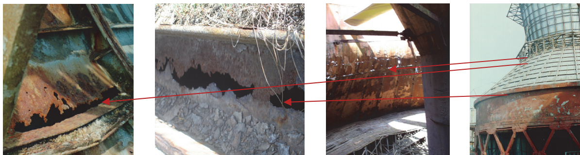
Рис. 3. Коррозионный износ элементов конструкции крупногабаритной градирни ПАО «Нижнекамскнефтехим» Figure 3. Corrosion wear of structural elements of a large-sized cooling tower of PJSC “Nizhnekamskneftekhim”
