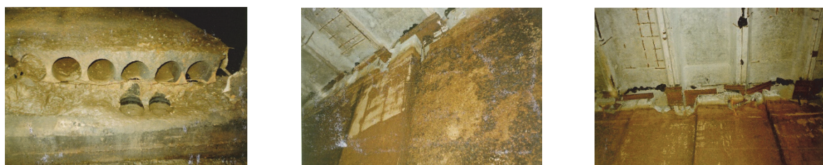
Рис. 4. Износ и разрушение элементов конструкции крупногабаритного отстойника ПАО «Нижнекамскнефтехим» Figure 4. Wear and destruction of structural elements of a large-sized sump of PJSC “Nizhnekamskneftekhim”
