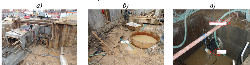
Рис. 4. Подземный переход на пересечении улиц Эсперанто-Качалова в Казани: а – процесс возведения подземной части дренажной камеры после сооружения ствола тоннеля; б – вымыв грунта из под ствола пешеходного перехода в ходе СМР; в – дренажная камера, процесс вымывания грунта из-под днища пешеходного перехода
