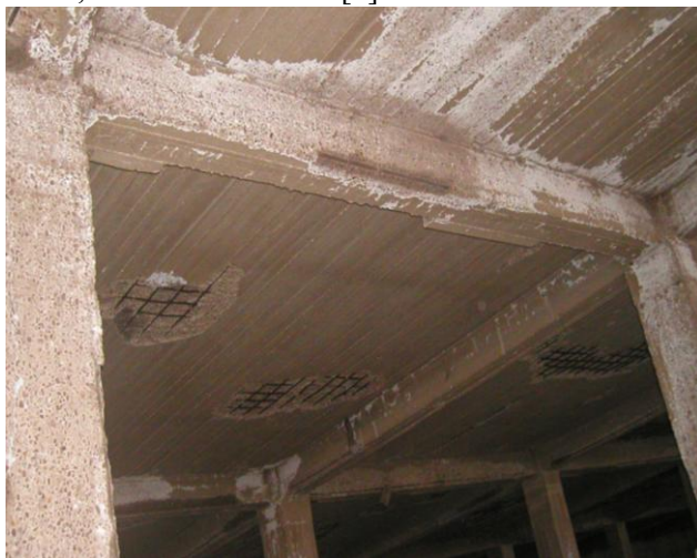
Рис. 3. Общий вид потолка цокольного этажа (ригелей, колонн, плиты перекрытия) после пожара с выпученными вверх участками плиты
