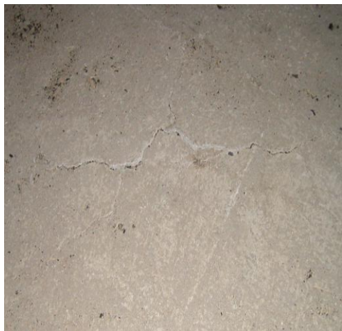
Рис. 4. Местное выпучивание вверх (куполообразное) плиты перекрытия цокольного этажа с образованием трещин
