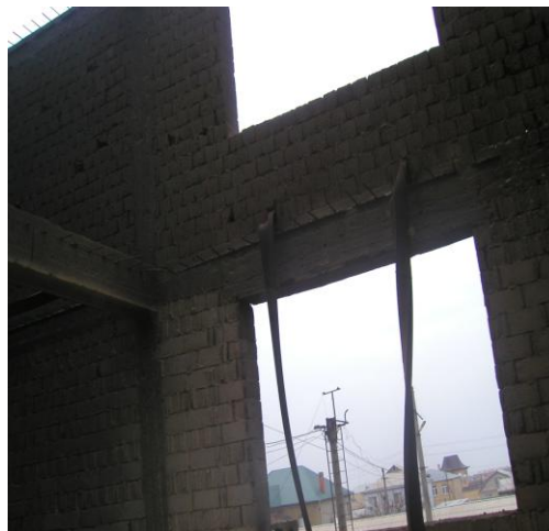
Рис. 5. Выход из строя металлических швеллеров
