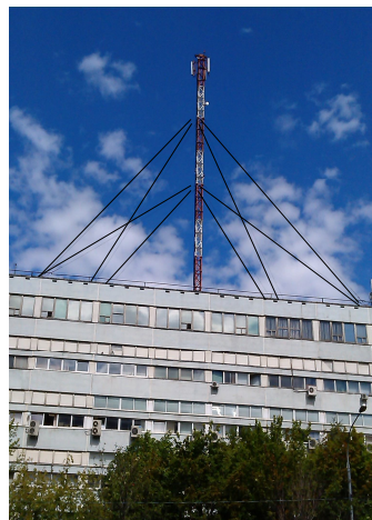
Рис. 31. Мачта с вантовыми оттяжками на покрытии здания
