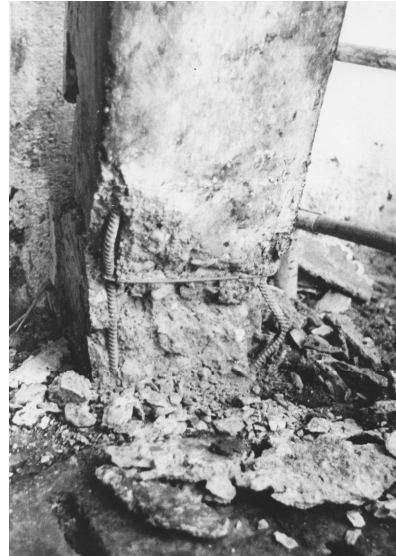
Рис. 2. Разрушение колонны в связи с неточностью монтажа, вызвавшего увеличение эксцентриситета продольных сил в плоскости изгиба и в перпендикулярной к ней плоскости
