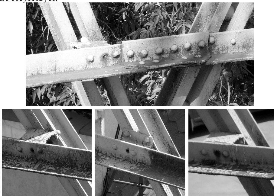
Рис. 3. 3-е промежуточное кольцо 1-й секции, неиспользуемые отверстия
