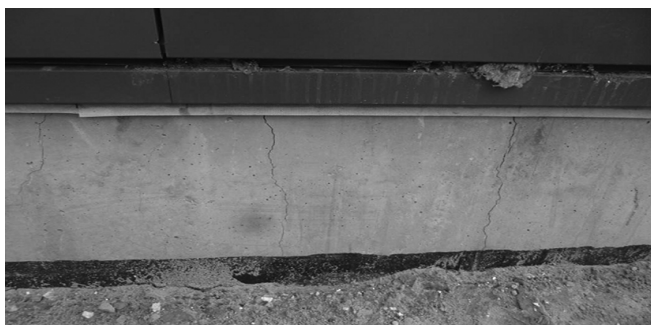
Рис. 1. Трещины в фундаментной балке раскрытием до 10 мм [Cracks in the foundation beam opening up to 10 mm]
