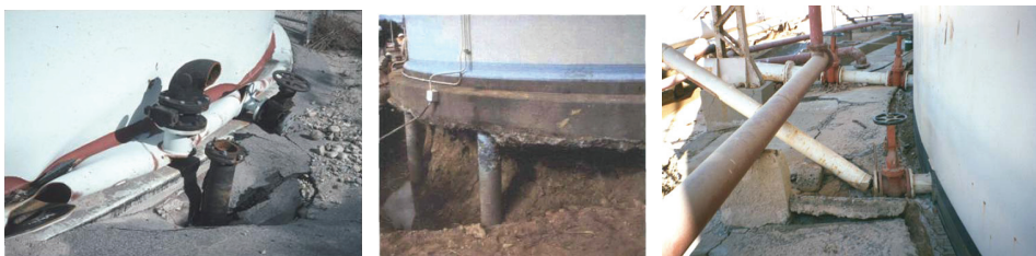
Рис. 1. Землетрясение на Аляске (1964 г.): потеря устойчивости нижней части корпуса, подъем днища от основания и повреждение узлов сопряжения корпуса с днищем и связи трубопровода
