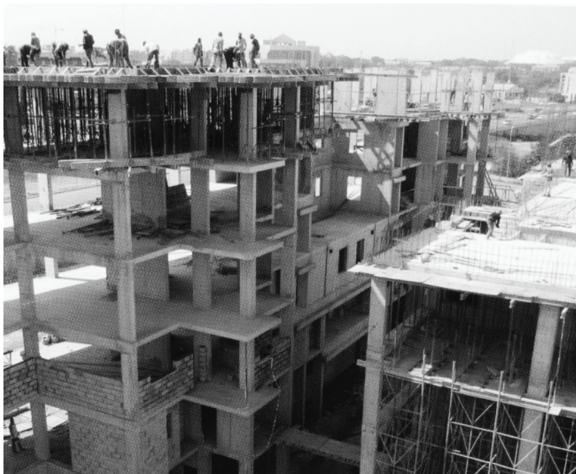
Рис. Выполнение строительно-монтажных работ по монолитному перекрытию дипломатического комплекса РФ в Нигерии (г. Абуджа) ОАО Главзарубежстрой
