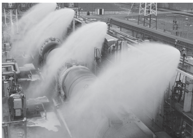
Рис. 4. Демонстрация работы стационарной пенной системы пожаротушения на эстакаде [11] (Display of the working of a stationary foam fire-fighting system on a flyover bridge [11])
