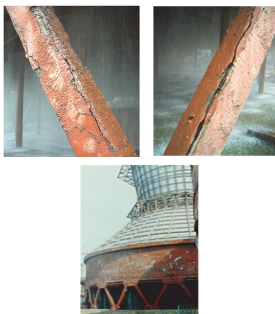
Рис. 1. Продольные угловые трещины в наклонных стойках крупногабаритной градирни СК-1200 [Figure 1. Longitudinal corner cracks in sloping racks large-sized coolers СК-1200]
